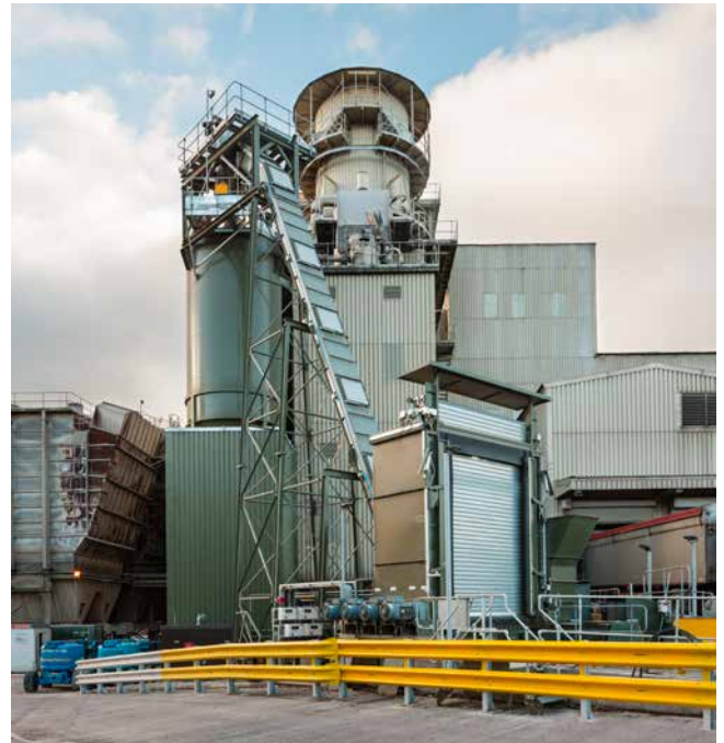
Bild 1: Annahmestation für PSP (vorbehandelte Klärschlamm-pellets), Förderer und Vorratssilo
